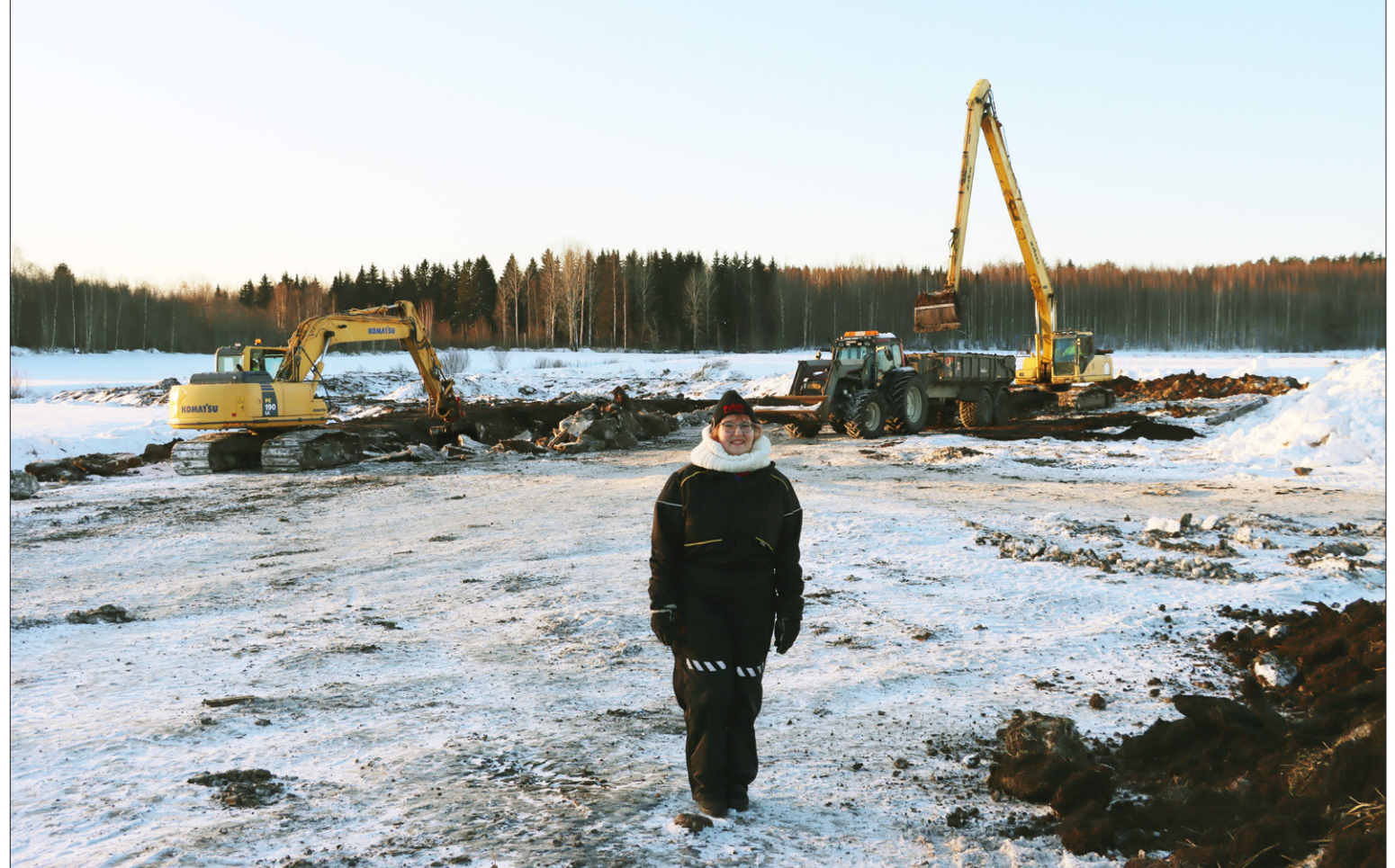
Projektiasiantuntija Saara Wilhelms vieraili Kuljakon Kostit' Opotan työmaalla kolmantena kaivuupäivänä. KUVA: ALEKSI KERÄNEN
